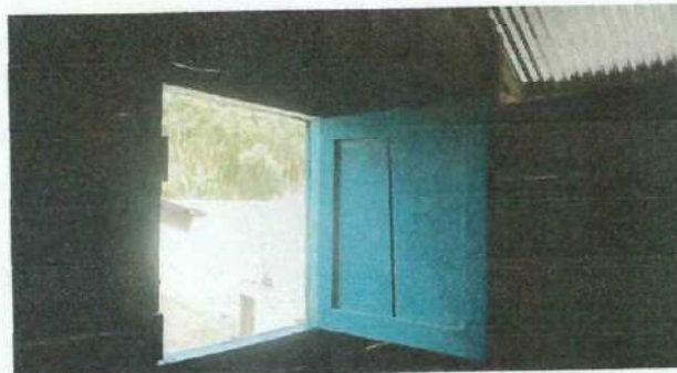
Foto 4: Imagen donde puede evidenciarse la necesidad de realizarse el renglon de trabajo VENTANAS, ya que actualmente se encuentra muy inseguro.
