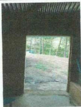
Foto 3: Vista de puerta que es necesaria cambiar a puerta de metal para brindar mayor seguridad al establecimiento.
