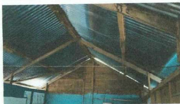
Foto 2: Vista interior de estructura de techo en mal estado, en donde se colocara estructura de metal.
