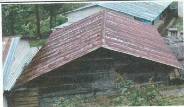
Foto 1: Vista de entechado que es necesario remozar ya que por el paso del tiempo se encuentra totalmente deteriorado.
